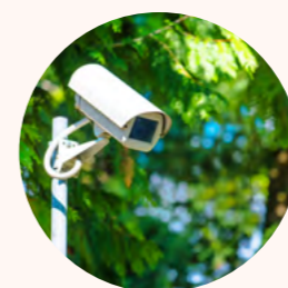
Telecamere a circuito chiuso.
