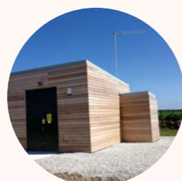
Sottostazione Ospita il quadro di comando.
