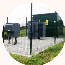
Trasformatore Aumenta la tensione.
